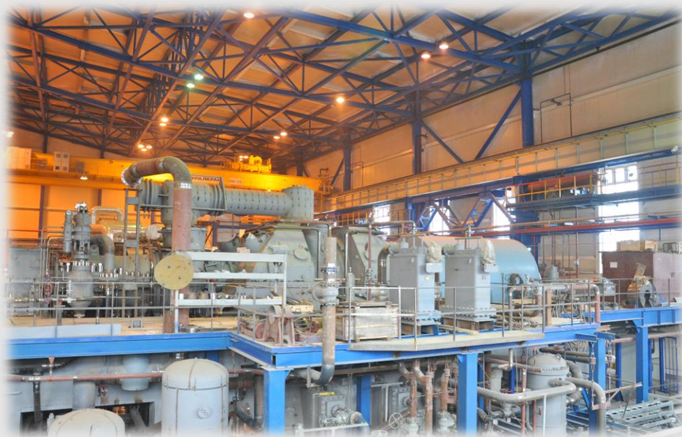
Томь-Усинская ГРЭС 240 МВт.
